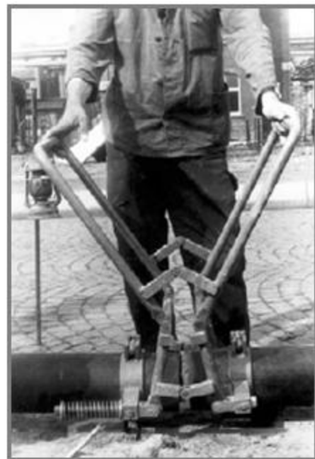
Aplicación manual de la presión de la placa calefactora en un proceso de soldadura a tope
